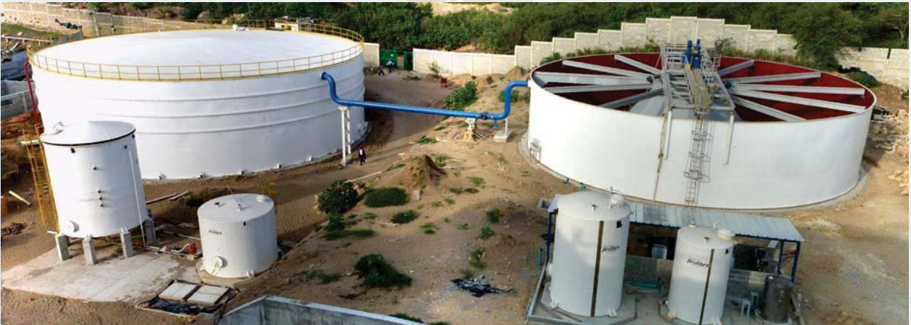
Sistema di trattamento acqua da 3000USgpm (680m 3 /hr) Solid contact clarifier, unità di dosaggio chimico (3), cisterna di stoccaggio da 4000m 3 , e unità di inspessimento fanghi
