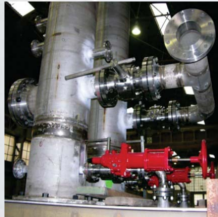
Filtrazione di Fuel Gas Total E&P - Russia
