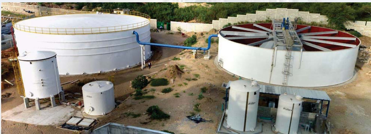
Impianto di trattamento acqua fanghi residuali presso la centrale elettrica Termoflores – Barranquilla - Colombia
